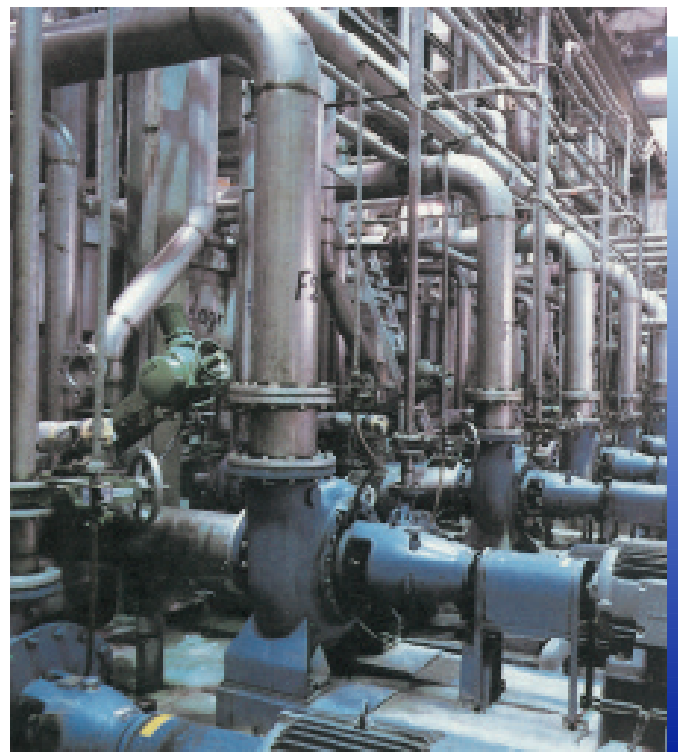
Verrohrung im konstanten Teil einer Kartonmaschine/ Piping system in paper plant
